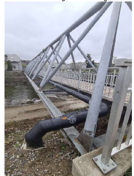
Vorlaufleitung über den Steg
